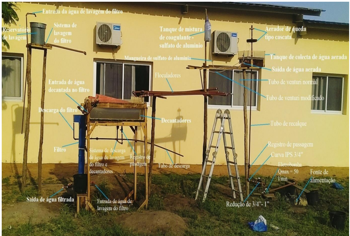
Figura 21: Sistema Completo de Tratamento de água instalado no ISPG
