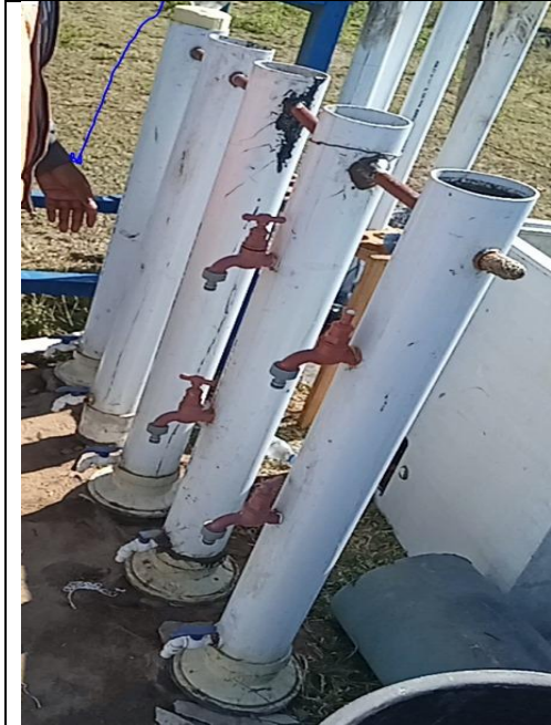
Figura 6: Reactores UASB montados
