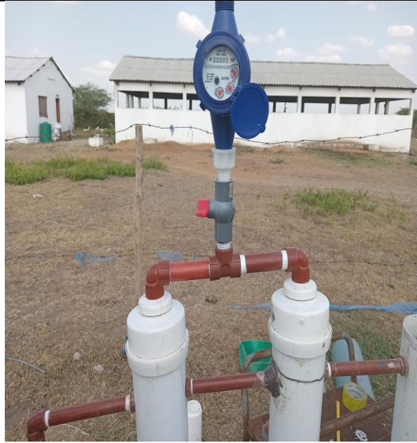
Figura 7: Hidrómetro montado nos reatores
