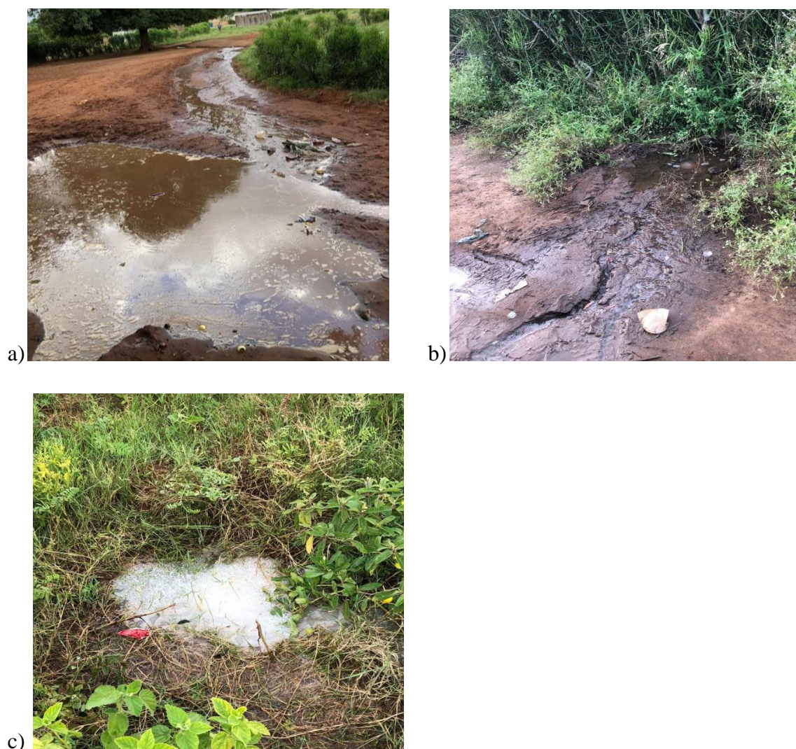
Figura 5- Imagens demonstrativas dos cenários de roturas comuns na rede de distribuição de Chibuto, a) – danos ambientais causados, pela demora na reparação das fugas; b) e c) – rotura nas condutas de água.
