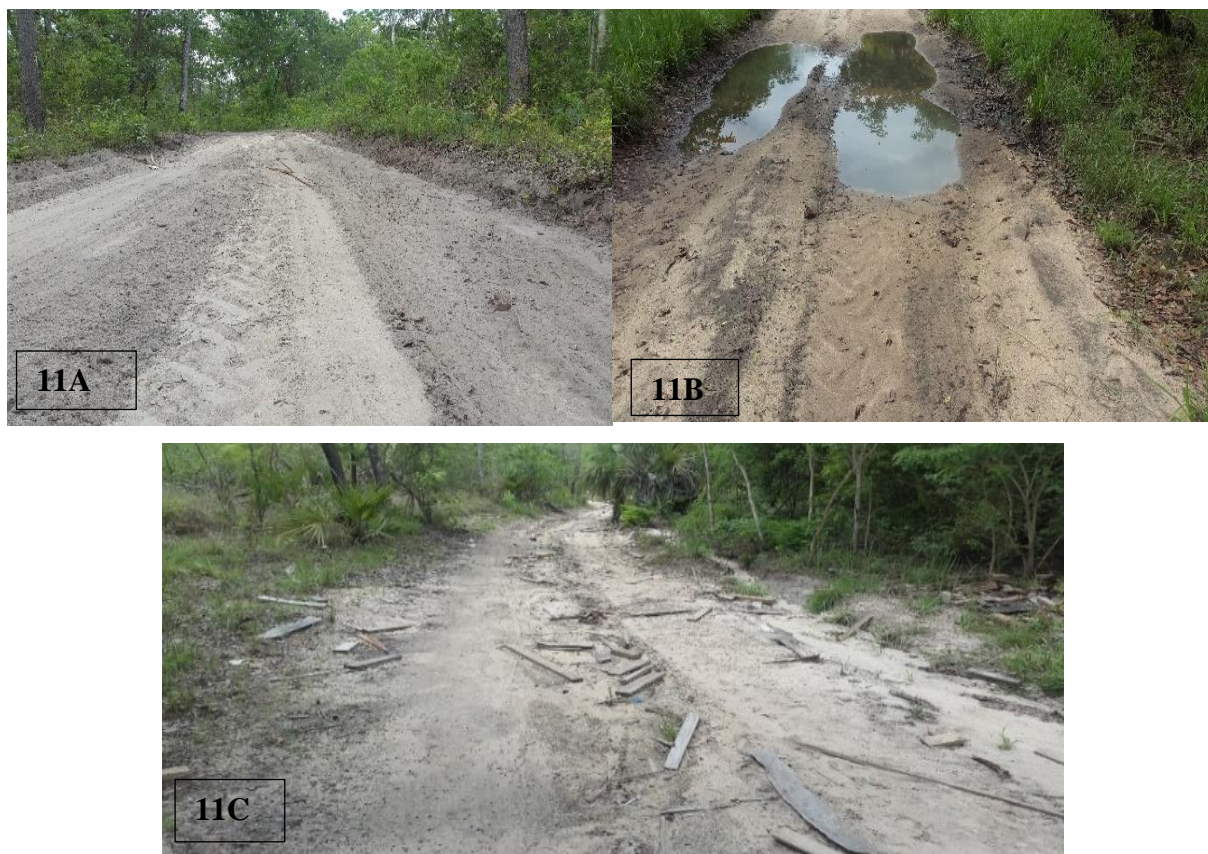
Figura 11: Estrada com secção transversal inadequada (11A: Estrada plana; 11B: poças de água; 11C: Início do processo erosivo)
