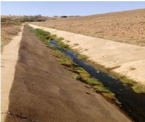
Anexo 9 – Aparecimento de infestantes na vala de drenagem
