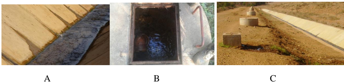
Figura 15: Anomalias causadas pela vazão de percolação: aparecimento da água no paramento montante da vala de drenagem no pé da jusante do DD (A), poço com fuga de água e má drenagem de água (B), aparecimento de água que sai do piezómetro (C).
