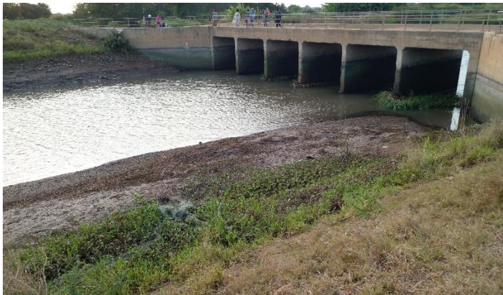
Figura 19: Níveis de água do ponto Nó no dia da limpeza do Hidroregulador 2
