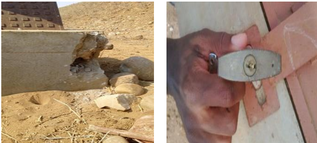
Figura 3. Vandalização das proteções dos piezómetros
