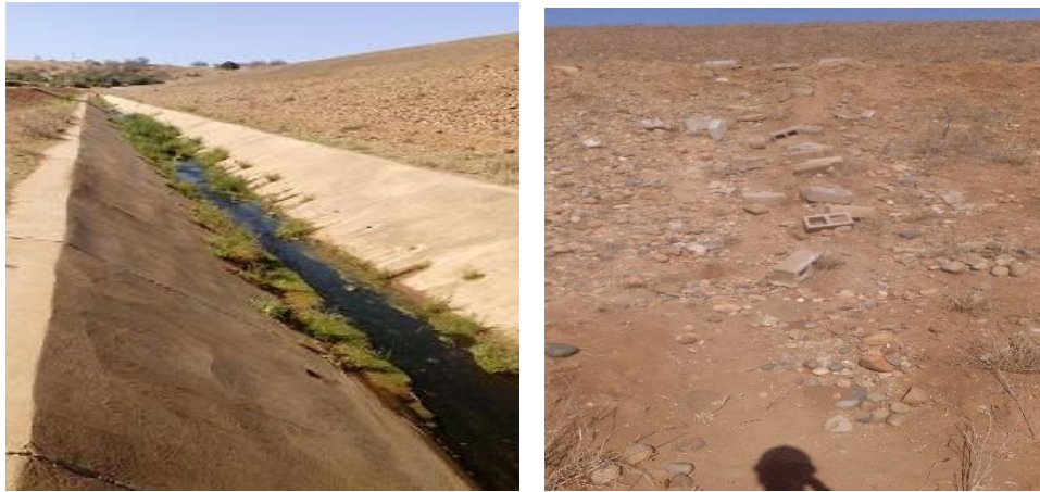
Figura 1. A imagem a esquerda mostra crescimento de vegetação na vala principal de drenagem e a direita a obstrução das vias de acesso às banquetas de cima
