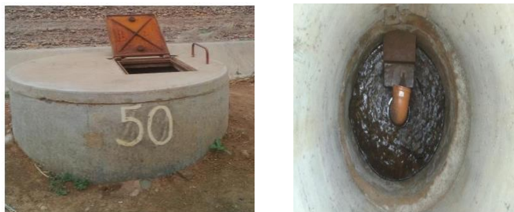
Figura 12. Poço de alívio
