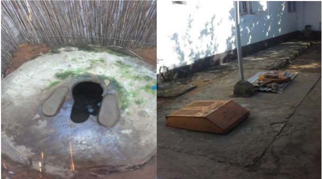
Figura 4: Modelo de latrinas existentes na área de estudo e fossa séptica não impermeabilizada.
