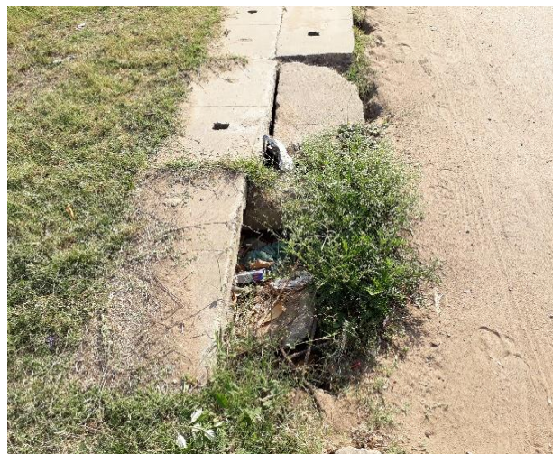
Figura 10. Sumidouros obstruídos por lixo e vegetação
