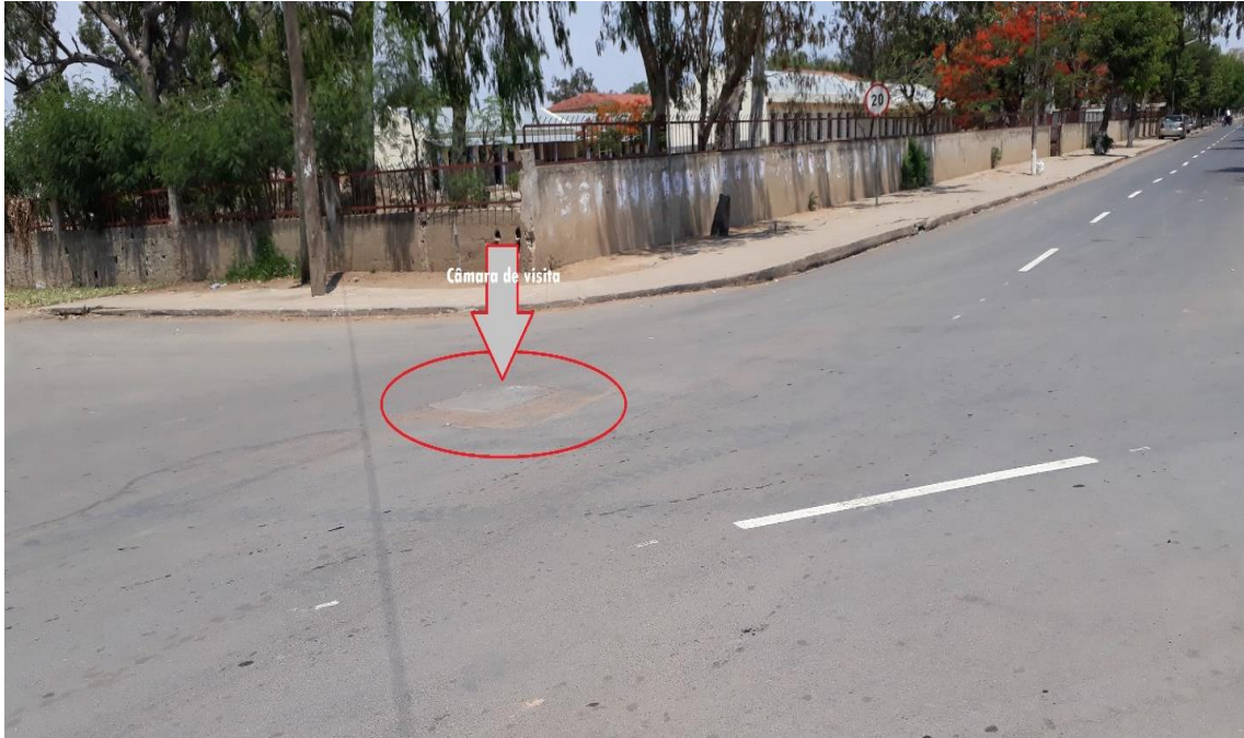
Figura 13. Câmara visitável aparentemente submerso no asfalto.
