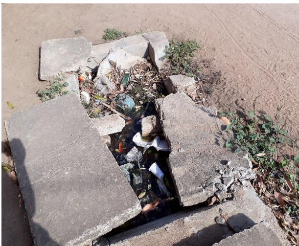
Figura 9. Obstrução dos sumidouros por lixo
