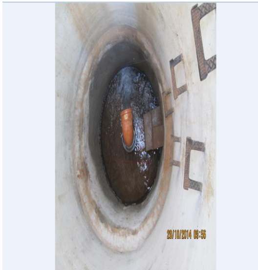
Poço de alívio
