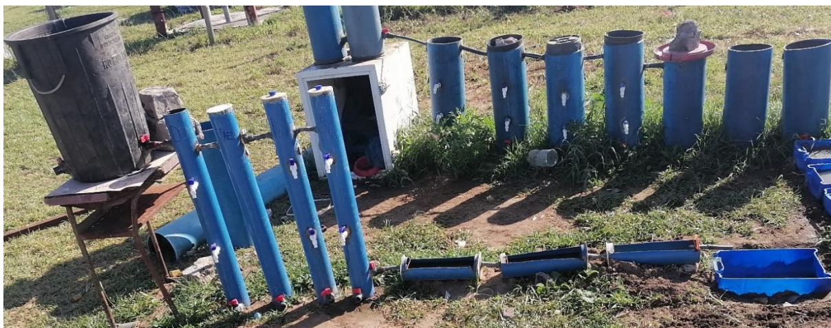
Figura 24: Sistema de tratamento em funcionamento.
